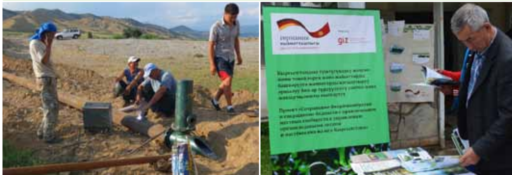
Установка гидротарана в селе Кыргоо Базар-Коргонского района, Кыргызстан.
